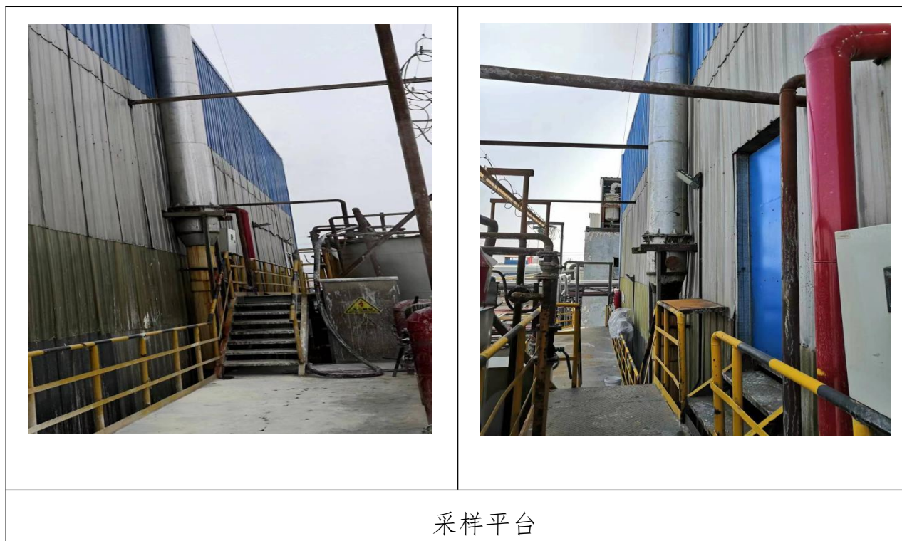
废气采样平台照片
